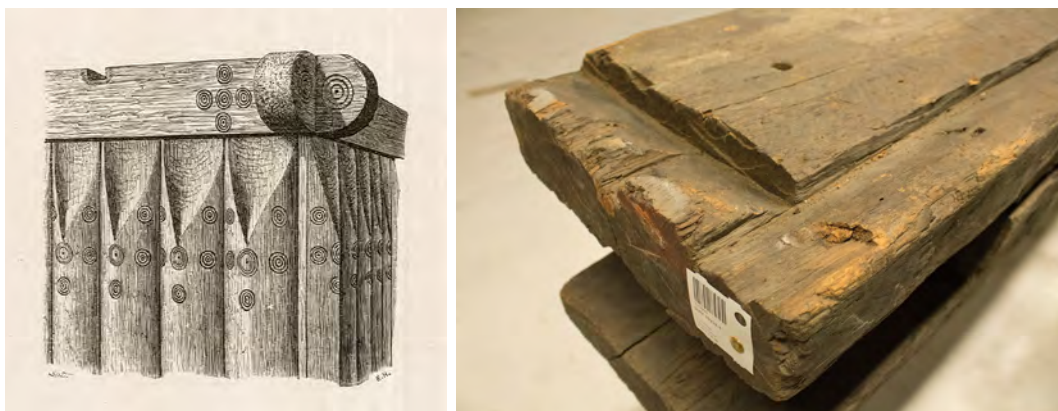
Bild 8-9. Till vänster, en tidig tolkning av konstruktionslösningen av hörnet i Hemse stavkyrka, av Emil Eckhoff och Olof Sörling. Tolkningens trovärdighet, att det inte fanns en rund hörnstav utan att stav mötte stav i byggnadens hörn, bekräftas i spåren i den bevarade syllen. Fotografi av Gunnar Almevik.
